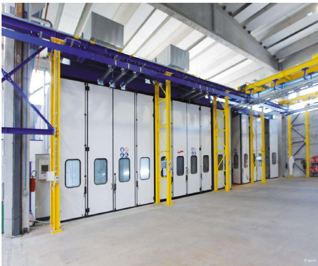
I tre forni di polimerizzazione.
